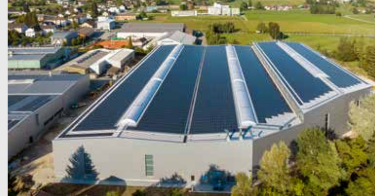
Die Photovoltaikanlage auf der Halle 5.
