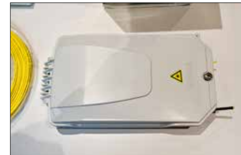
Glasfasernetz: Jedes Gebäude erhält einen BEP-Kasten.
